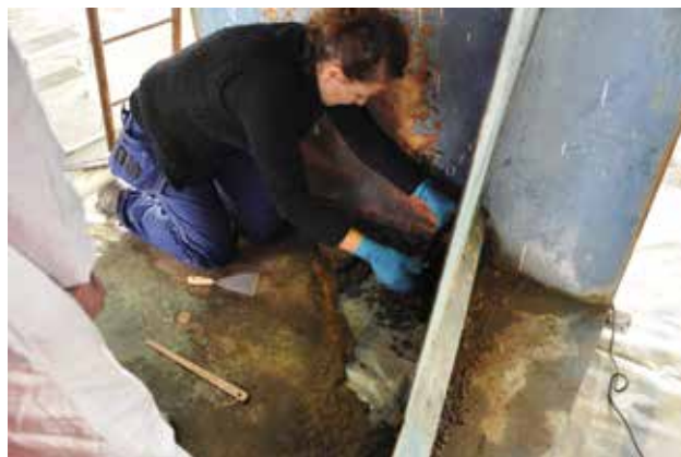
11 Oštećenje u podnici (foto: S. M. Sunara, 2014.) Damage to the bottom plate (photo: S. M. Sunara, 2014)
