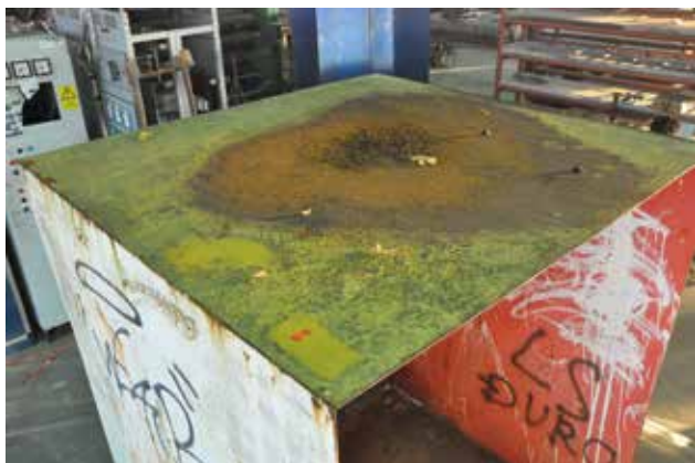
3 Oštećenja na gornjoj plohi gornje ploče (foto: S. M. Sunara, 2014.) Damages to the upper surface of the upper plate (photo: S. M. Sunara, 2014)
