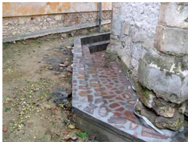
11 Potporni zid sa stubom izveden nakon sniženja terena uz donju zonu zidova svetišta crkve sv. Martina biskupa u Varaždinskim Toplicama, stanje tijekom radova 2010. godine (foto: M. Korunek)
