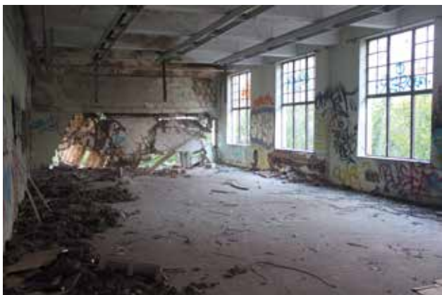
18 Urušeni zidovi u 2. katu dvorišne zgrade tvornice (foto: M. Pretković, 2013.)
