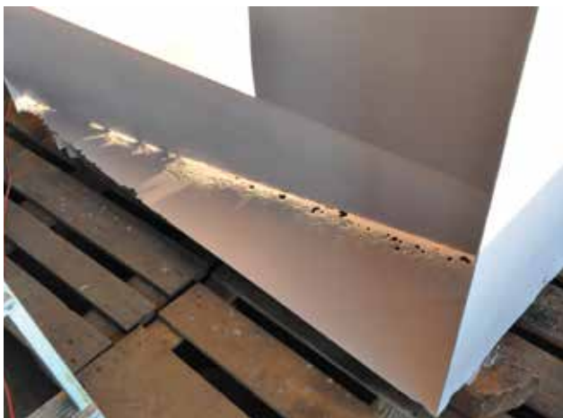
15 Donji dio skulpture nakon nanošenja temeljnog premaza; vidljiva su oštećenja čeličnih ploča (foto: S. M. Sunara, 2014.)
