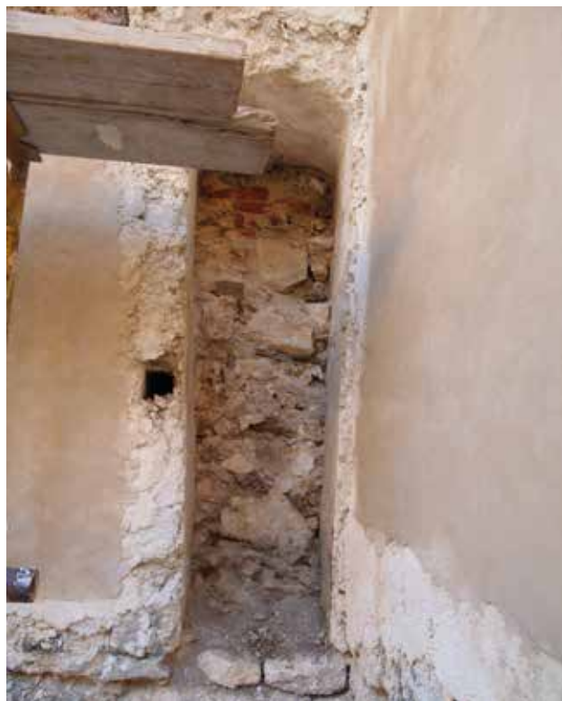
14 Niša na vanjštini sjevernog zida svetišta crkve sv. Martina biskupa u Varaždinskim Toplicama nakon djelomičnog uklanjanja ispune, stanje tijekom radova 2011. godine (foto: M. Korunek)
