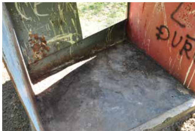
4 Podnica skulpture bila je zahvaćena potpovršinskom korozijom (foto: S. M. Sunara, 2013.) The bottom plate was affected by subsurface corrosion (photo: S. M. Sunara, 2013)
