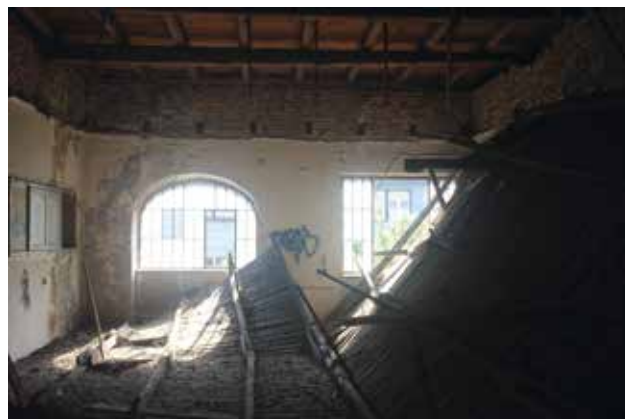
19 Urušeni strop u prostoriji 2. kata koja gleda na Erdödyjevu ulicu (foto: M. Pretković, 2013.)
