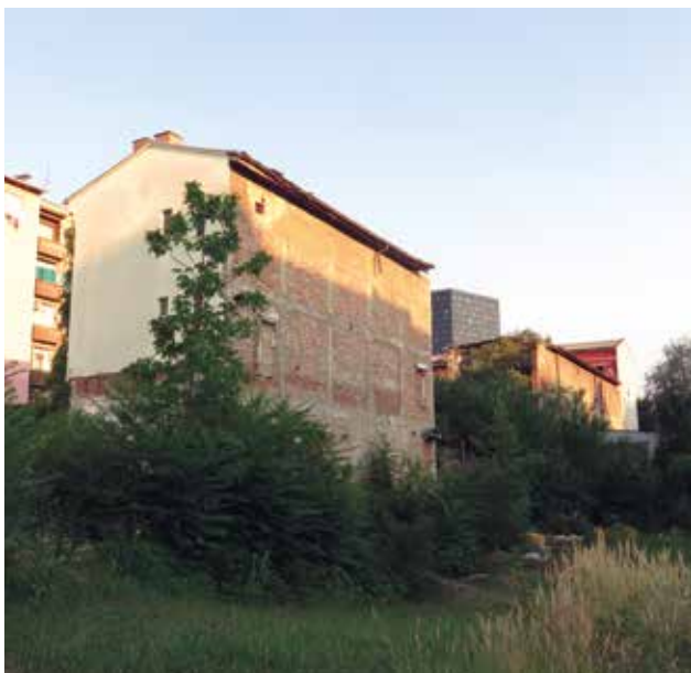
24 Pogled s vanjskog dvorišta na urušeni središnji dio dvorišne zgrade (bivša zgrada za dobrobit radništva) (foto: M. Pretković, 2015.)
